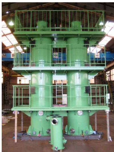
SS製 脱硫塔
